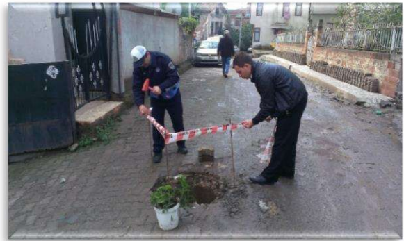
Kırılan Kanalizasyon Bacası Kapağı Güvenlik Önlemi Alınması
