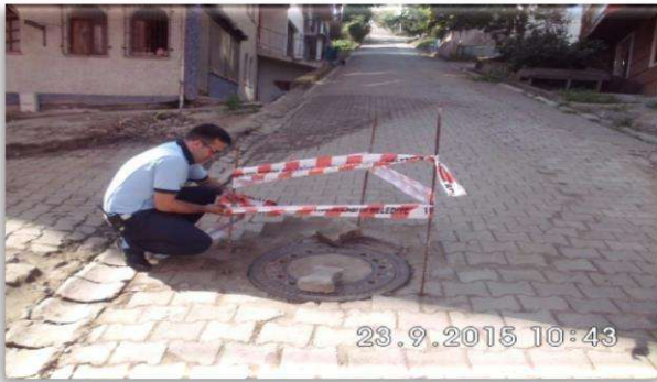
Kırılan Kanalizasyon Bacası Kapağı Güvenlik Önlemi Alınması
