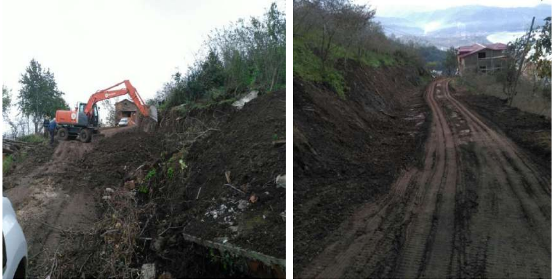
Boztepe Mahallesi Hacıhamzaoglu Sokakta Heyelan Temizleme İlk/Son Hali
